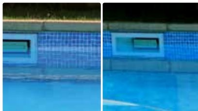
Linia osadu na ścianie basenu
